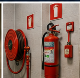
EXTINTORES E SISTEMAS
